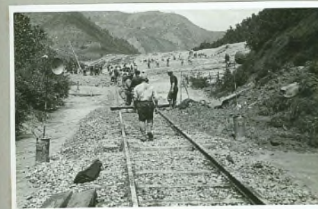
Brisighella - frana di S. Eufemia
